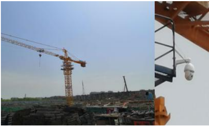
定位干扰源塔吊某品牌无线监控干扰
